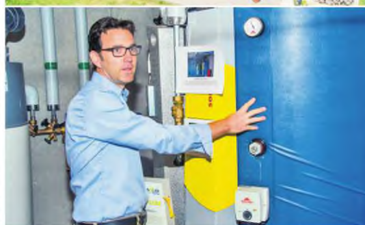
Diese beiden Bilder zeigen das Plus-Energie-Haus der Familie Zollinger in Schaffhausen. Unten zeigt Daniel Zollinger den Wärmespeicher für sein Einfamilienhaus. Bilder: zvg.
